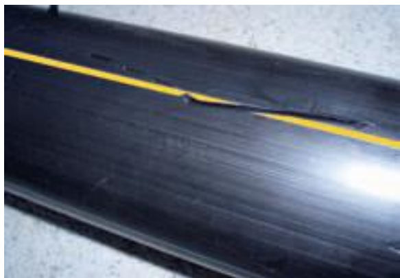
Obr. 4 - Vznik trhliny na potrubí PE
