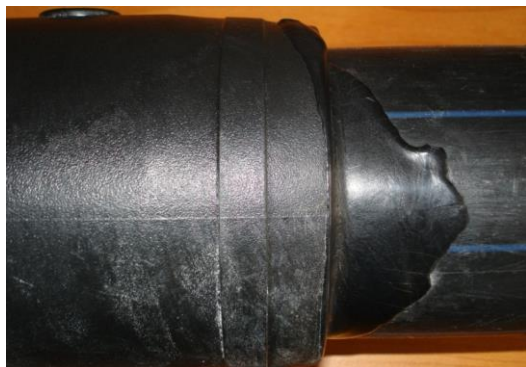
Obr. 11 - Príklad chyby pri vizuálnej kontrole – pretečenie elektrotvarovky
