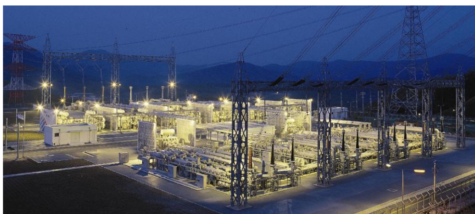
Obr. 2 Elektráreň je významná prevádzka s produkciou nadbytočného CO 2
