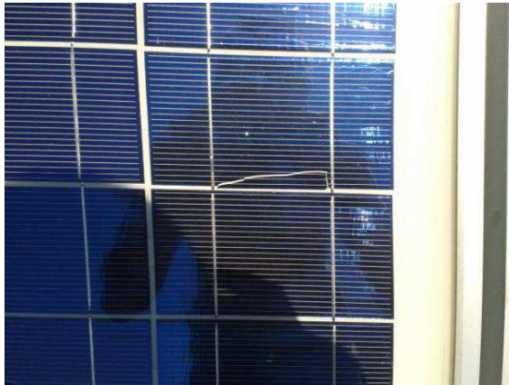
Obr. 3 Kontrolovaný poškodený fotovoltaický článok
