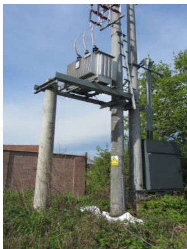
Obr. 3 Transformátor umiestnený mimo dosah
