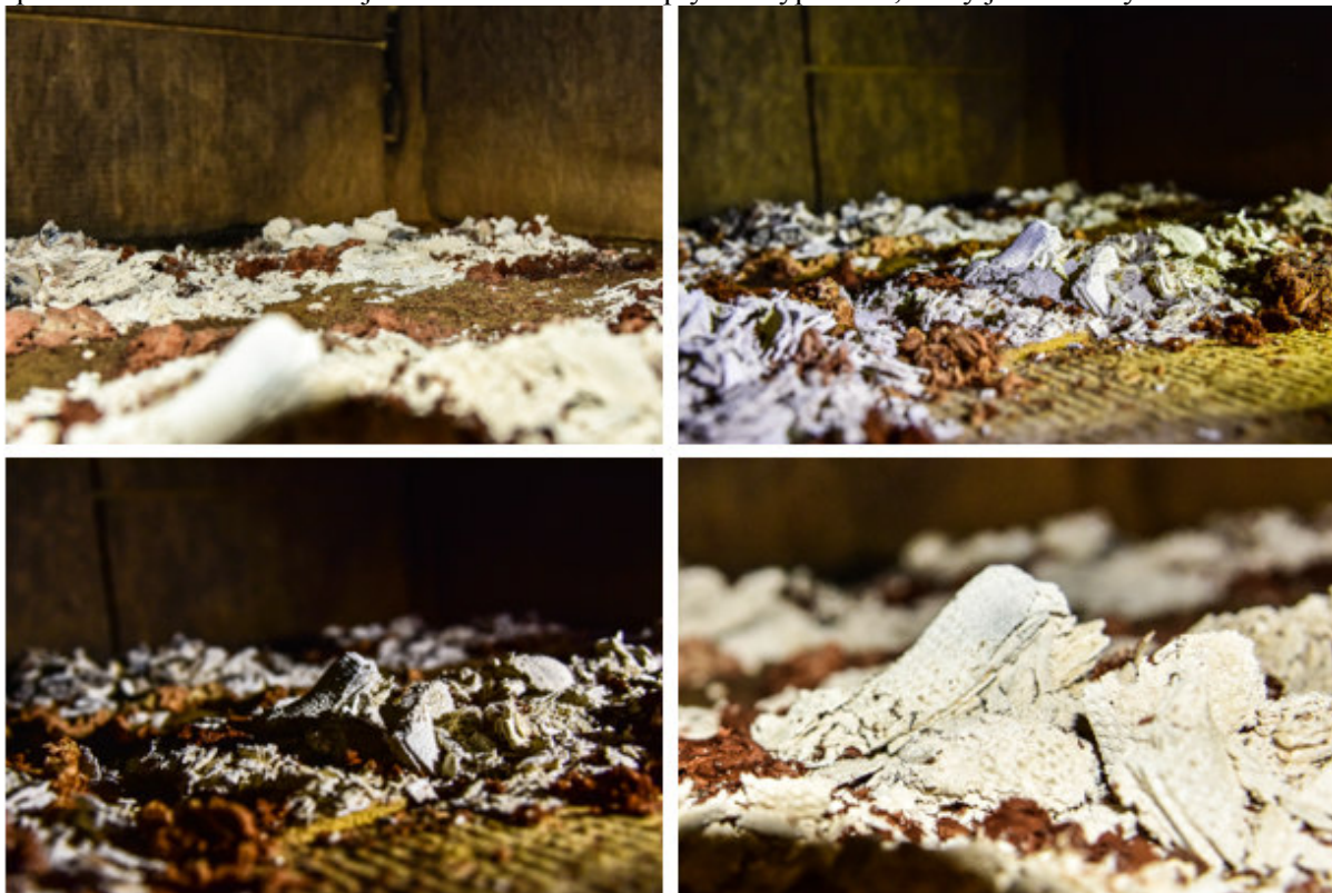
Obr. 4 Deštrukcie spôsobené vplyvom požiaru
