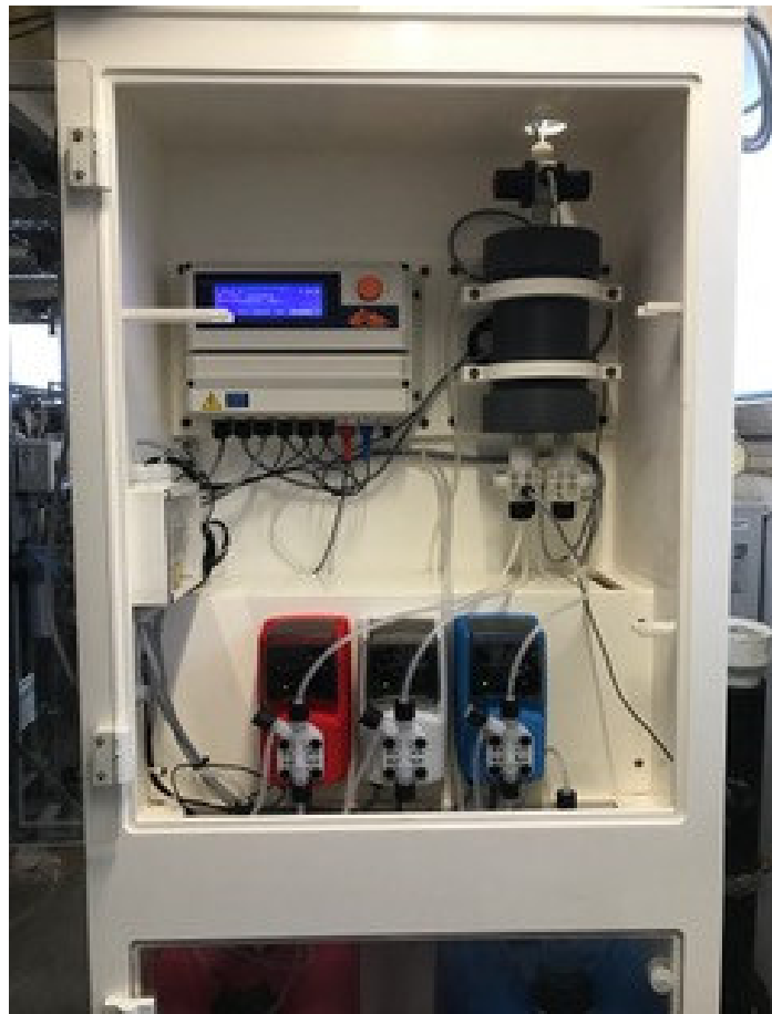
Bild 5 Chlordioxidgenerator – links oben die Steuerung, rechts oben die Mischkammer, unten Dosierungspumpen. 32
